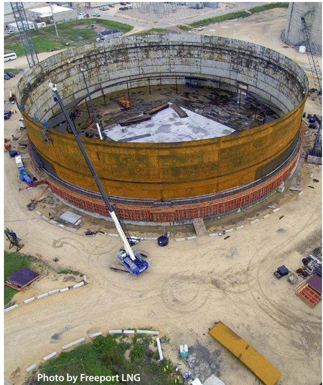
Photo by Freeport LNG
